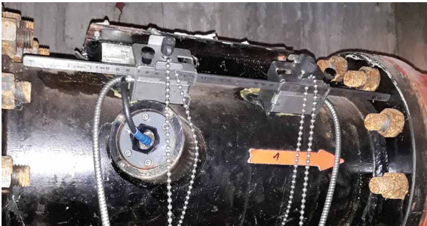
Rysunek 2 Sondy przepływomierza zamontowane na rurociągu
