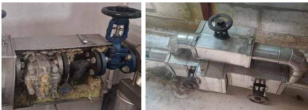
Rysunek 3 Skrzynki izolacyjne zaworów
