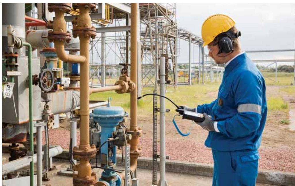
Rysunek 6 Kontrola instalacji przy użyciu miernika SDT 340
