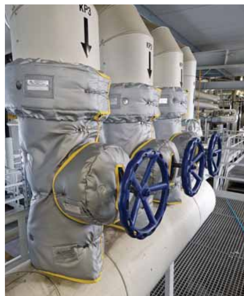
Rysunek 1 Termoizolacja zaworów odcinających
