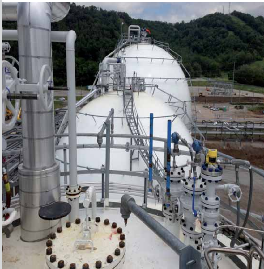
Rysunek 3 Sonda Vegapuls 64 zamontowana na dachu reaktora
