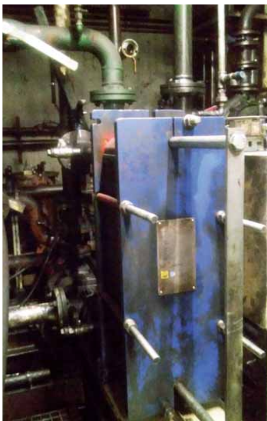
Wodna chłodnica płytowa – to jej awaria może być źródłem wody w oleju
