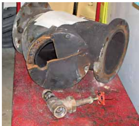
Rys. 1 Uszkodzenia armatury wywołane uderzeniami wodnymi
