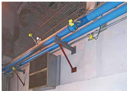
► Układ monitoringu sprężonego powietrza FCI
