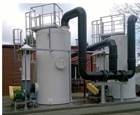
◀ Instalacja neutralizacji chloru oparta na suchym sorbencie w SUW
